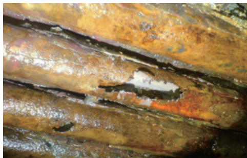
图 5 生物质锅炉受热面腐蚀
