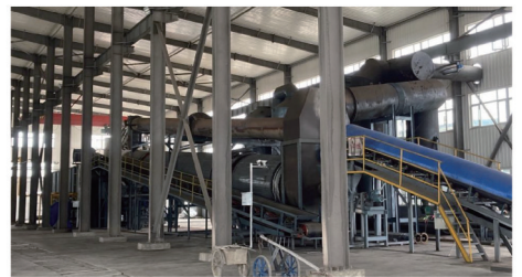
图 1 设备现场运行图
