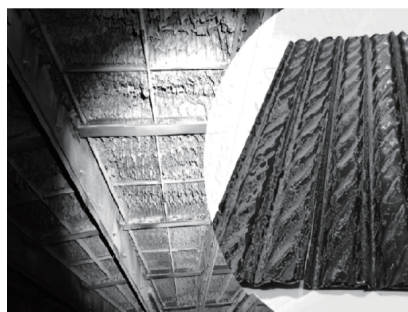
图3 空气预热器冷端蓄热板积灰和腐蚀 [12]
