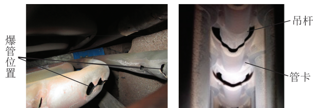
图3 外置式换热器磨损及爆管
