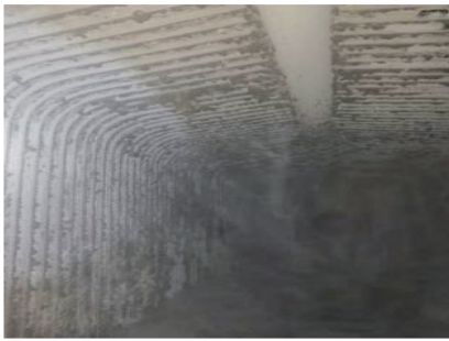
图2 某地区煤粉工业锅炉结焦情况
