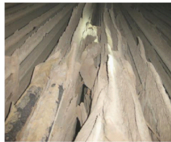
图4 燃用准东煤过热器沾污结渣严重
