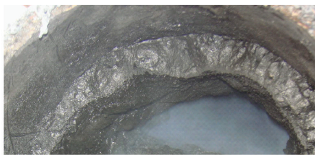
图5 减压塔进料加热炉炉管上部结焦堵塞
