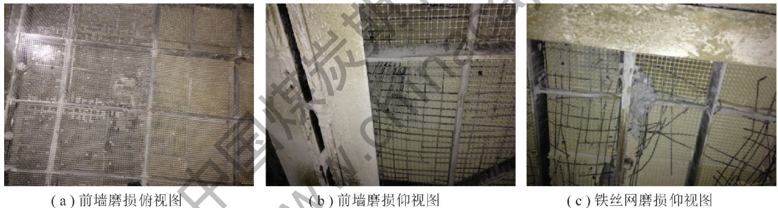
图 9 B 侧催化剂磨损堵塞情况
