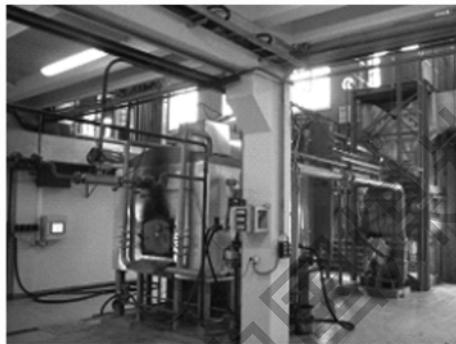
图 1 水煤浆燃烧装置外观
