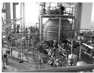
图 3 投煤量 750 t/d 的多喷嘴水煤浆气化中试装置
